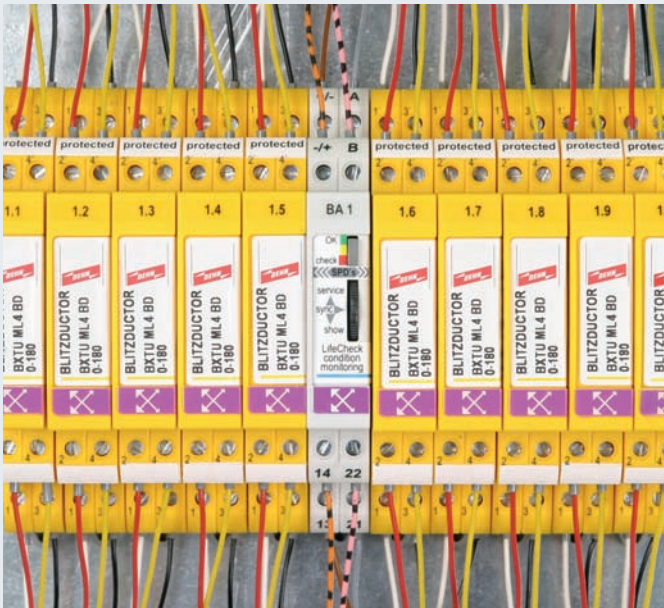
Moduł monitorujący (szary) pracujący w instalacji.
